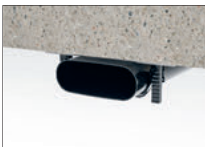
Canale piatto su solaio cantina
